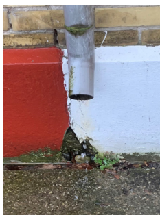
Soklen er beskadiget som følge af vand fra tagudløbet.
